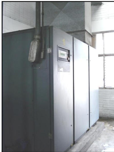
รูปที่ 4.8 เครื่องอัดอากาศที่ปรับปรุง
