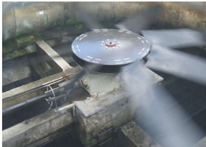
ENCON Fan Operation
