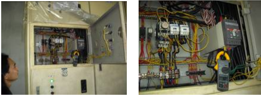
รูปที่ 3 ภาพแสดงการติดตั้งเครื่องมือวัดไฟฟ้าที่ตัว cooling tower
